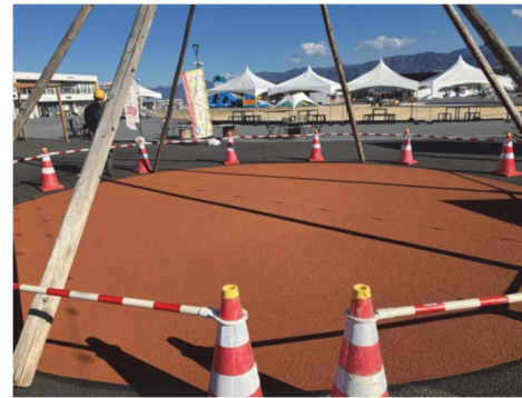
図2 廃瓦チップ舗装実証工事 (山梨県南アルプス市内の商業施設内)
