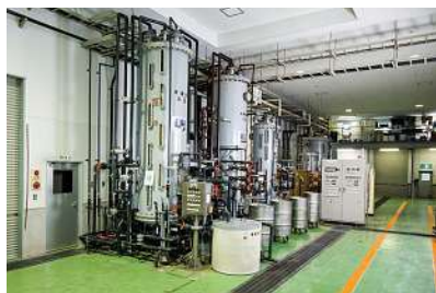
イオン交換樹脂再生設備
