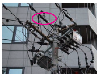
絶縁カバー設置状態
