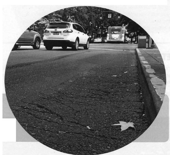
資料 2-24 損耗した道路
