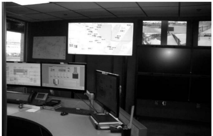
資料 2-13 水道局における操作盤
