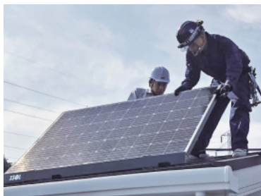
住宅に事業用建物からグラウンドまで、あらゆる規模の太陽光発電システムを手掛けている
