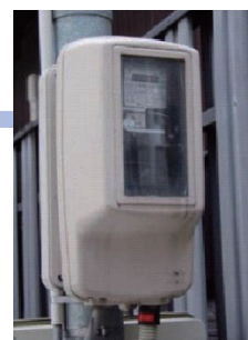
計器箱設置状態
