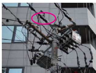
絶縁カバー設置状態
