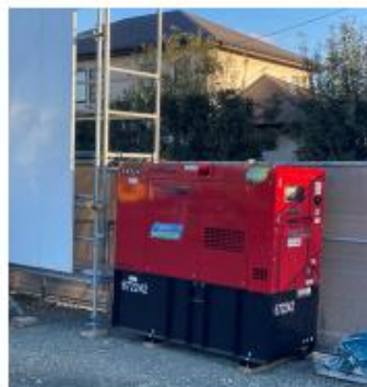
利用する発電機（発電容量45KVA）
