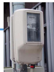
計器箱設置状態
