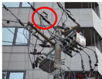
絶縁カバー設置状態
