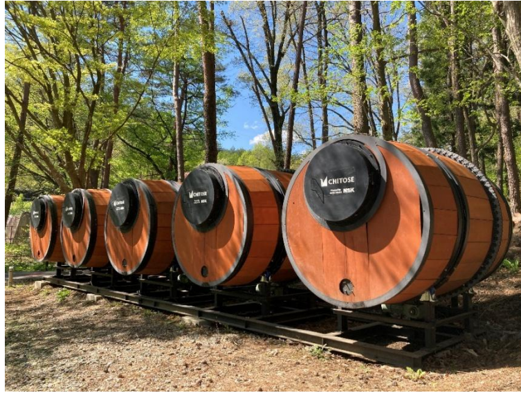
盛岡市動物公園内(公開エリア)に設置した「ちとせバイオマス変換プラント」
