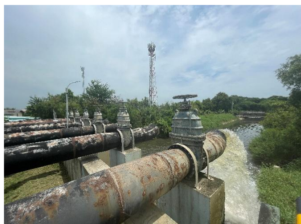
工業団地での洪水対策(排水ポンプ)
